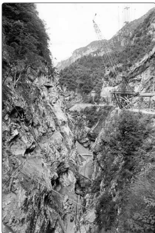
1956. Forra della Scaletta. Si gettano le fondamenta della diga di Ponte Pià
